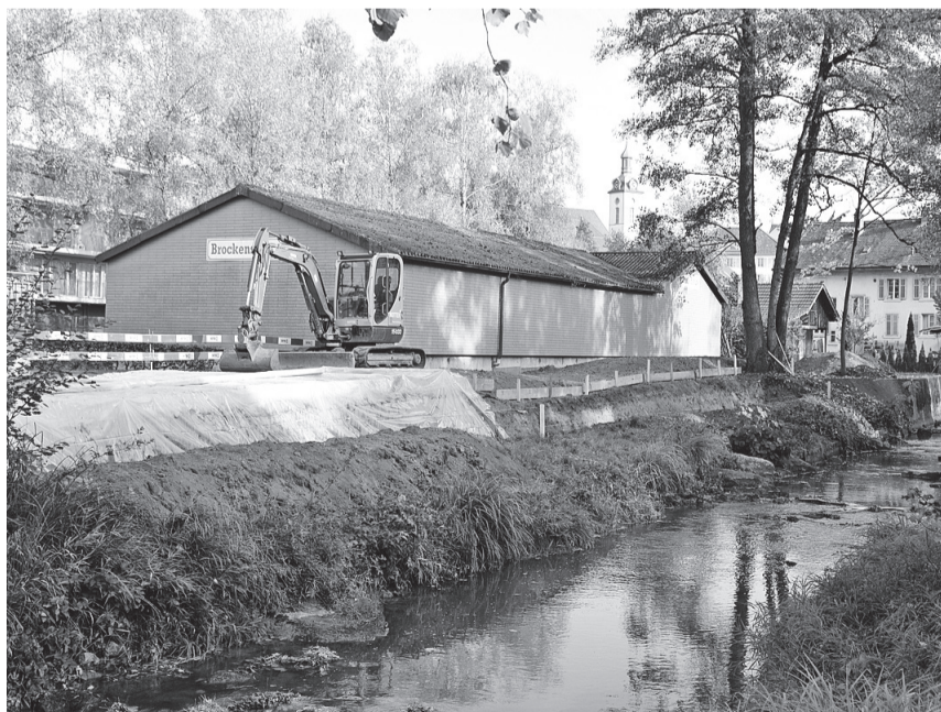
Schutzmauer entlang des Bünzwegs zwischen der Brockenstube und der Güpffstrasse: Die Vorarbeiten haben bereits begonnen.
