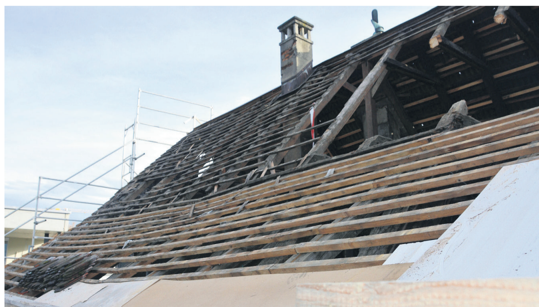
Die Demontage des Dachs hat begonnen: Die Konstruktion des Dachstuhls ist eher ungewöhnlich.
