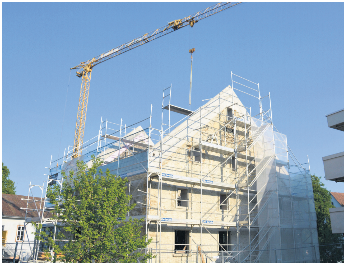
Nach Verzögerungen und Stützmassnahmen wieder auf Kurs: Bis Ende Jahr sollten der Umbau und die Sanierung des Schlösslis fertig sein.
