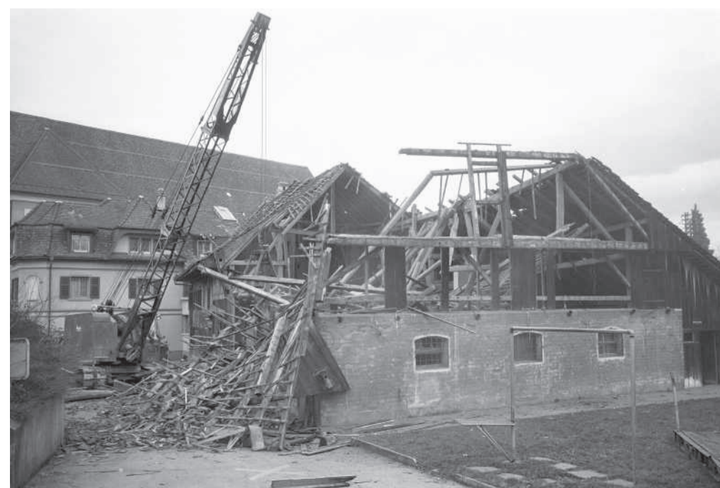
November 1981. Die Gemeinde lässt das Kuhn-Jäger-Haus auf Vorrat abbrechen. Erst nach dem Abbruch überlegt sich der Gemeinderat, wie das Areal künftig genutzt werden könnte. Es wird ein provisorischer Parkplatz. 37 Jahre später wird daraus ein definitiver. Er ist jetzt sauber gestaltet, auch für Feste verwendbar und hat einen eigenen Namen: Parkplatz Kirchenrain . RUEDI ZULAU
